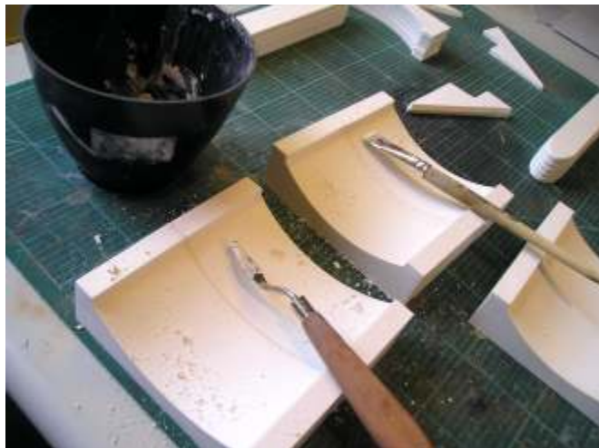
Die Stöße werden mit sämig angerührten Spachtelgips verspachtelt. Anschließend, noch vor dem Abbinden, wird der überschüssige Gips mit einem festen Borstenpinsel abgebürstet. Nur in den Fugen bleibt der Gips hängen.
